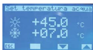
Visualizzazione del set della pompa di calore/chiller
